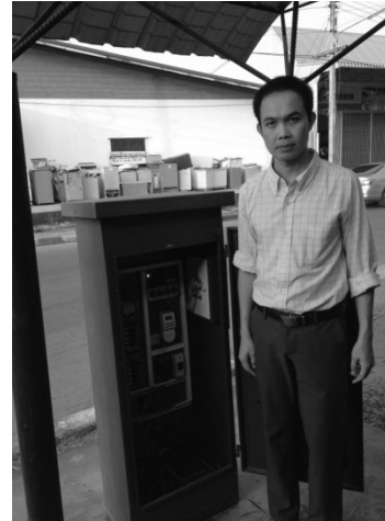
รูปที่ 19 แผงควบคุมเครื่องควบคุมสัญญาณไฟจราจร
