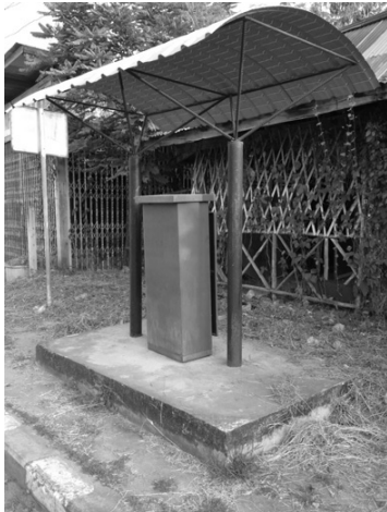
รูปที่ 18 เครื่องควบคุมสัญญาณไฟจราจร
